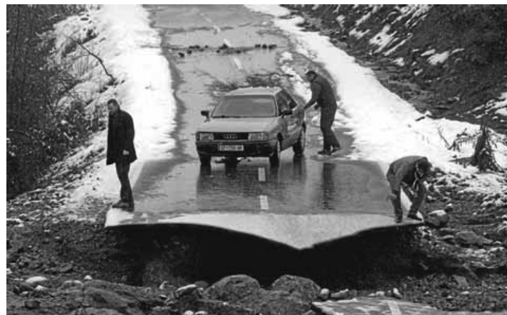
Una carretera realment tallada, a Kosova. Les fortes pluges van provocar dissabte una gran esllavissada de terres que va destruir aquesta carretera situada al centre de Kosova ■ EFE
